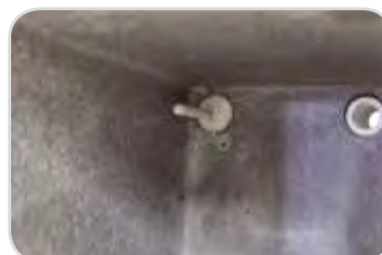
Termočlánek a větrací komínek v komoře pece
